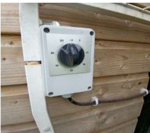
Minuterie qui enclenche le compresseur
